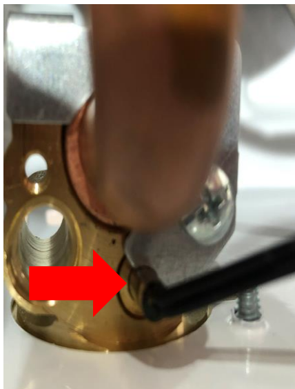
Imagem 7 - Sensores de temperatura saída/entrada de água
