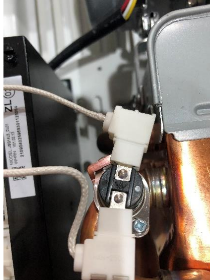
Imagem 15 - Limitador de temperatura (ativação 75°C)
