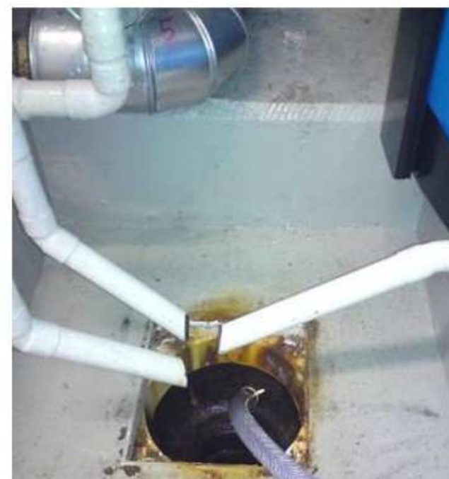
Diretamente na rede pluvial: NÃO!
